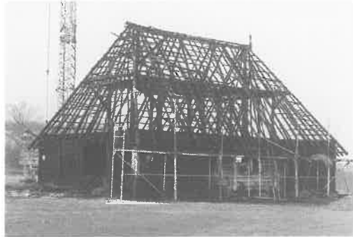
Abb. 15: Das am 29.11.1998 ausgebrannte Haus.
