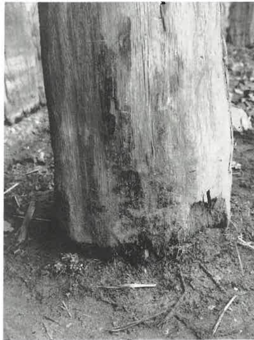
Abb. 9: Auch andere Pfosten des Rössener Hauses zeigen die Zerstörung des Splintholzes im Boden. Das festere Kernholz ist nach sieben Jahren dort noch nicht merklich angegriffen. Das führte im Bereich der Bodenoberfläche zu einer deutlichen Verringerung des Pfostendurchmessers.
