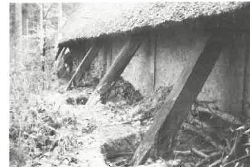
Abb. 2: Schräge Pfosten an der Rekonstruktion des schiffsförmigen Hallenhauses in Oerlinghausen drei Jahre nach der Fertigstellung. Am zweiten Pfosten ist deutlich das angegriffene Holz im Bereich der Dachtraufe zu erkennen.
