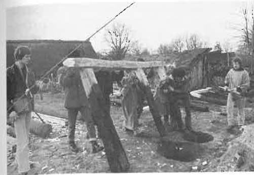
Abb. 8: Am Boden werden die angebrannten Pfähle der Außenwand an der Außenwandpfette befestigt und dann, als Ganzes zusammengebaut, in die Pfahllöcher gesetzt.
