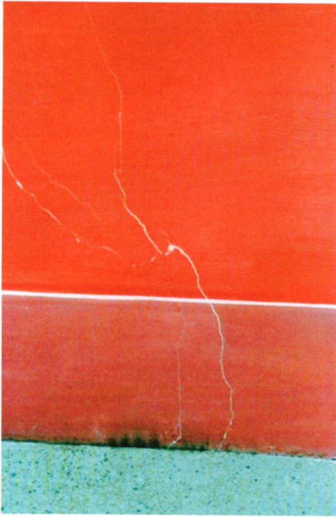
Abb. 4: Durch die Estrichdehnung nach außen gedrückte Wand, dadurch Risse und Eintritt von Ruß und Rauchgasen aus dem hypokaust in den Raum, AP Carnuntum, Villa Urbana. – The wall has been pressed outwards and has partially torn. Due to this, soot and flue gas were able to escape from the hypocaust.
