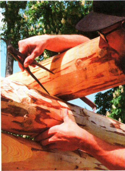
Abb. 6: Die individuellen Wölbungen der Fußpfetten wurden mit einem Zirkel auf die Unterseiten der Binderbalken übertragen. – The individual curvatures of the wall plates were transferred to the tiebeams with a pair of iron compasses.
