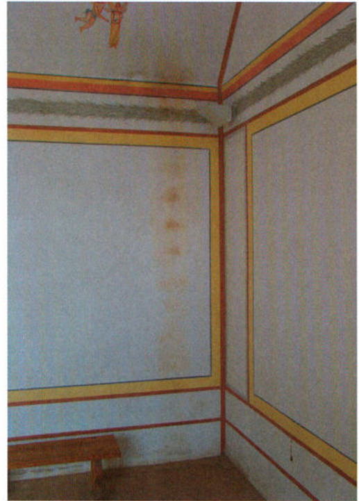
Abb. 3: Versottung im tepidarium . – Corrosive condensation in the tepidarium .
