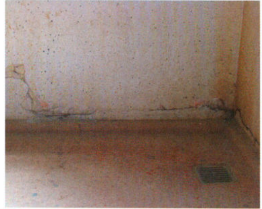
Abb. 5: Waagerechte Risse über dem Fußboden im caldarium . – Horizontal cracks above the floor of the caldarium .
