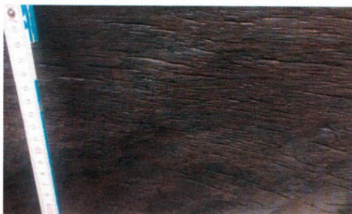
Abb. 8: Rissige Oberfläche (Fissuren) am Nachbau. – Fissured surface on the replica.
