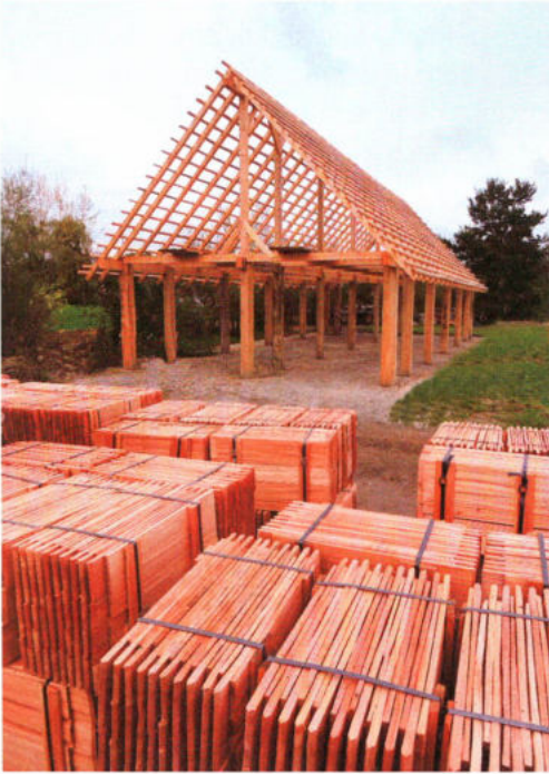
Abb. 13: Die Dachschindeln aus gespaltenen Lärchen sind vorbereitet. Um ein dichtes Dach zu erhalten, müssen sie so gesetzt werden, dass sie sich gegenseitig überlagern wie die Schuppen eines Fisches. – The shingles of split larch wood are prepared. To get a leakproof roof they have to be put on the laths in a way that they overlap each other like the scales of a fish.
