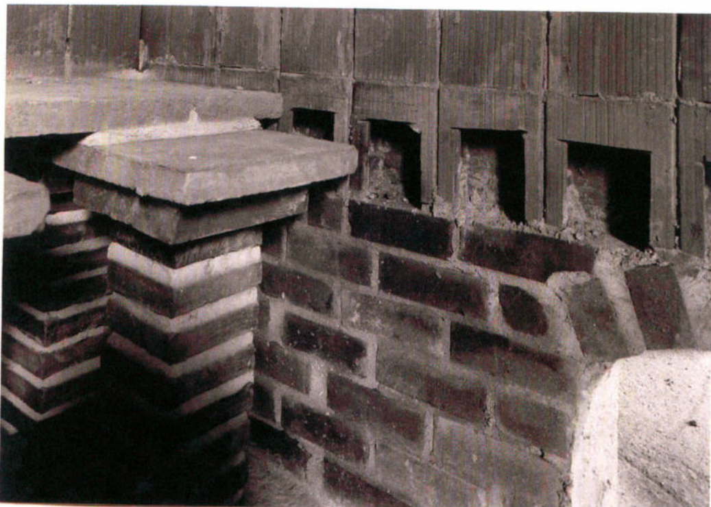
Abb. 6: Herbergsthermen während der Erbauung. Konstruktion der suspensura im Anschluss an die tubulatur im caldarium vor Aufbringen des opus signinum . – The Roman baths at Xanten in the building process. The construction of the suspensura adjacent to the tubuli prior to casting the opus signinum floor.
